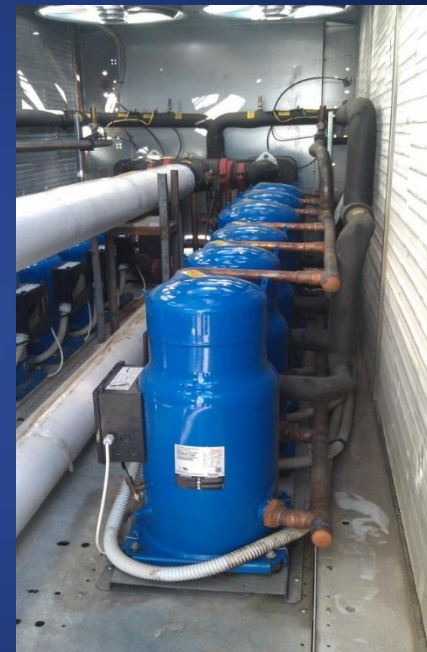
Компрессорная установка чиллера
