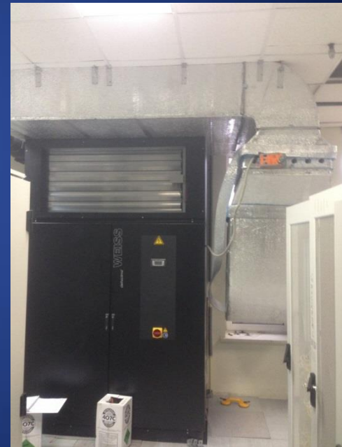
Установленная система Free Cooling
